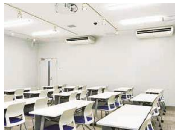
ダイキンエアコンの特約店として様々な空調設備に対応 写真はダイキン工業様様のホームページより
